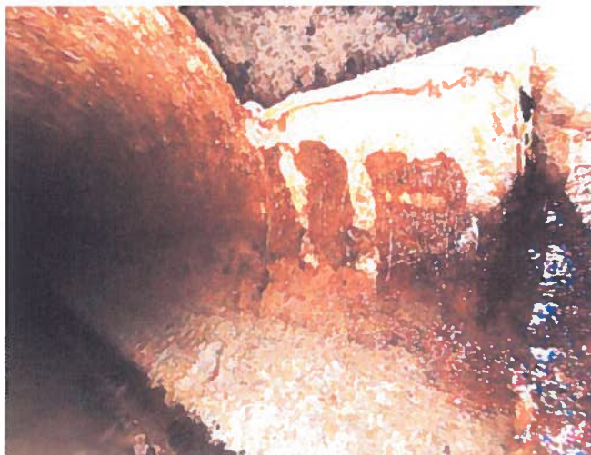
Neuenbürg Untere Reute MW DN 500 SB fließende Infiltration am Pointliner
