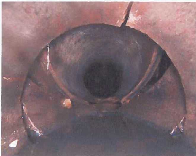
Ambach Neufeldstraße MW DN 250 Stz Rohrbruch / Versatz
