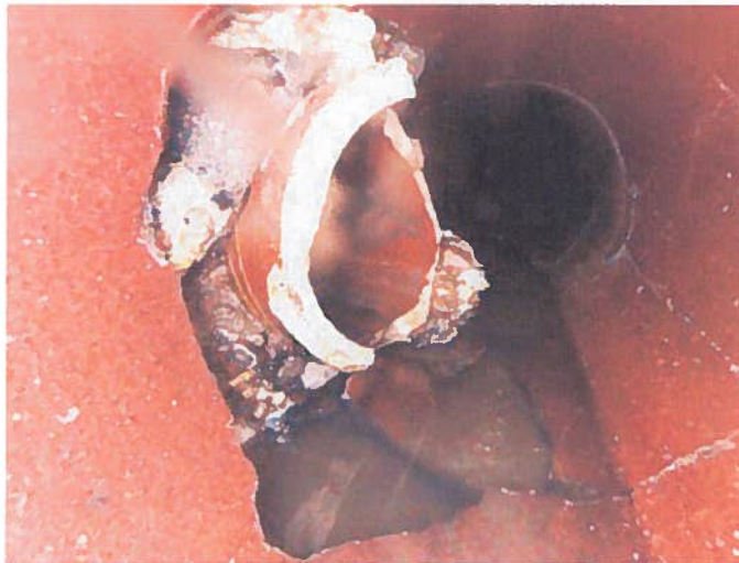
Ambach Baumstraße MW DN 250 Stz Rohrbruch
