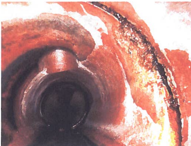
Neuenbürg Unterwässerweg MW DN 300 Stz tropfende Infiltration an Muffe
