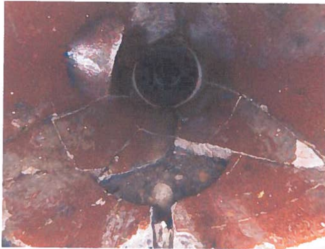
Ambach Lutherstraße MW DN 250 Stz Rohrbruch
