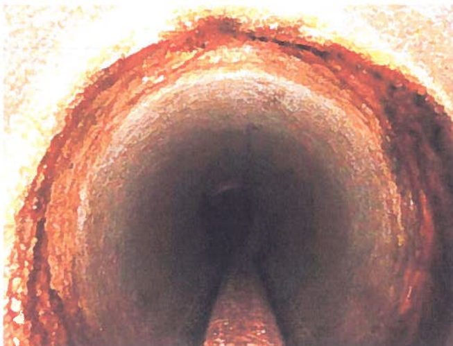
Neuenbürg Bohnenbergerring MW DN 300 SB tropfende Infiltration an Muffe
