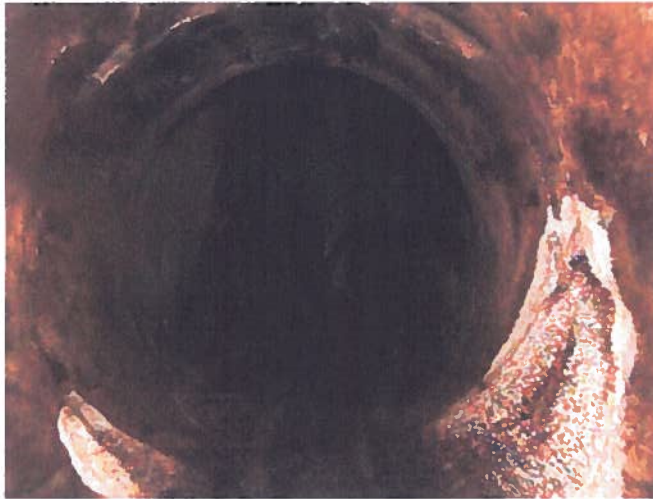
Neuenbürg Albert- Schweitzer-Straße MW DN 500 SB tropfende Infiltration an Muffe
