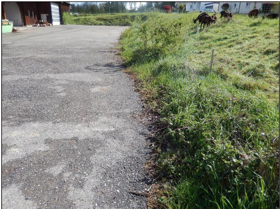
Foto 3: Der Übergangsbereich zwischen Böschung und Asphalt...
