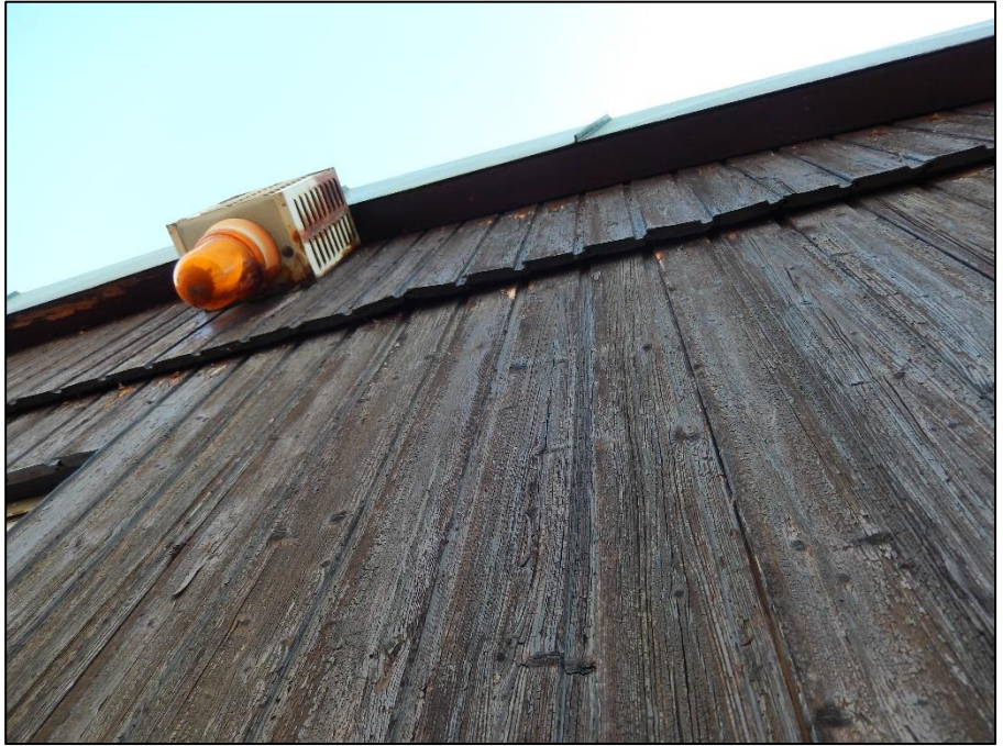
Foto 8: Die Gebäude weisen zahlreiche Spalten auf, die als Einfluglöcher für Fledermäuse geeignet erscheinen (2/4).
