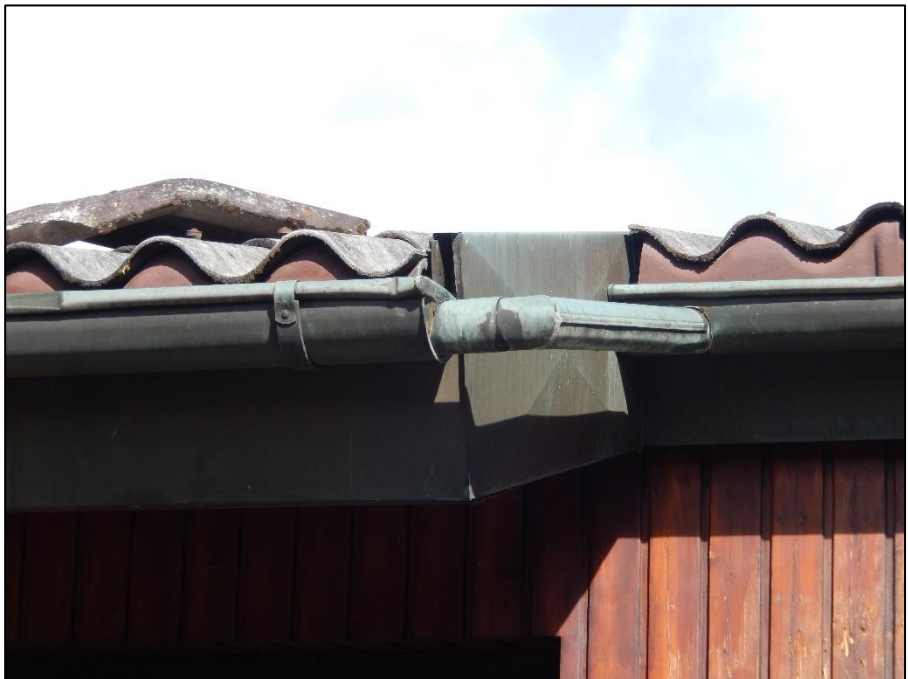
Foto 7: Die Gebäude weisen zahlreiche Spalten auf, die als Einfluglöcher für Fledermäuse geeignet erscheinen (1/4).
