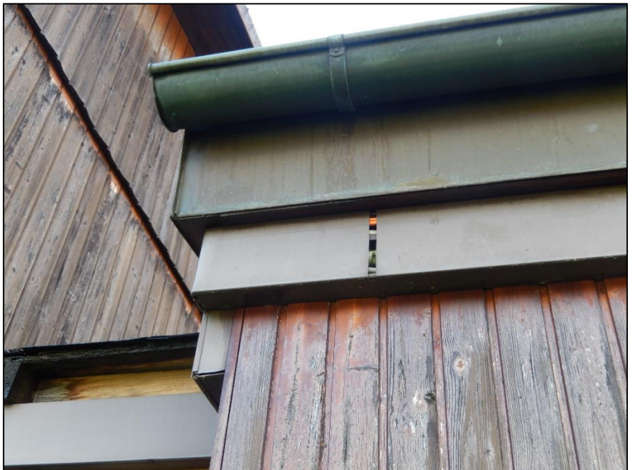
Foto 9: Die Gebäude weisen zahlreiche Spalten auf, die als Einfluglöcher für Fledermäuse geeignet erscheinen (3/4).
