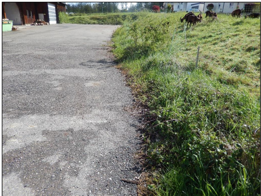
Foto 3: Der Übergangsbereich zwischen Böschung und Asphalt...
